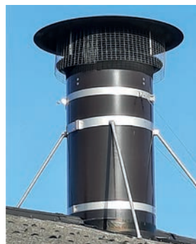
Выхлопные трубы с защитой от птиц.
