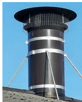
Kominy wentylacyjne zabezpieczone przed ptactwem.
